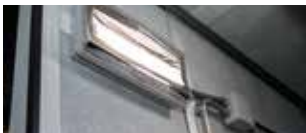
Sistema de iluminación interno
