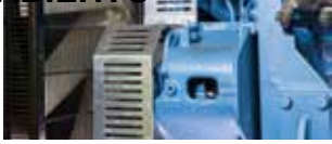
Dispositivos de protección de partes móviles y giratorias
